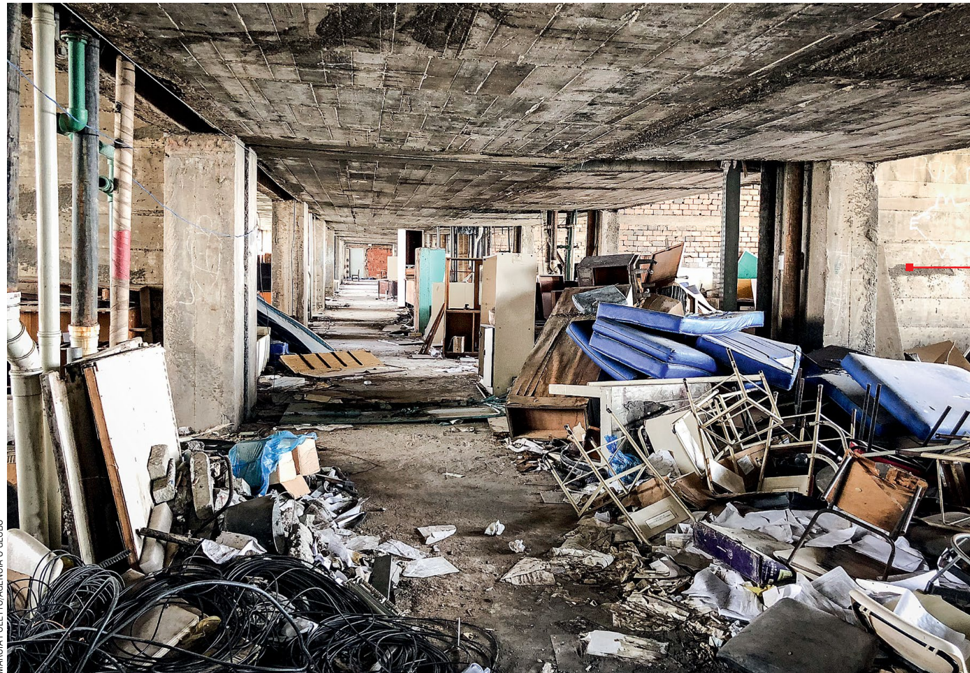
DESCASO O Hospital Universitário Clementino Fraga, no câmpus da UFRJ, em 2018
