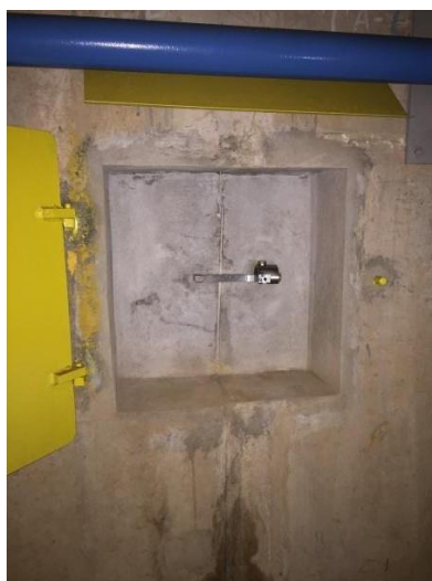
Fotografia 4= Medidor triortogonal de junta da casa de força I.
